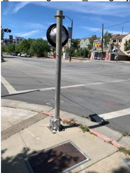
31_N 7 St Light Pole_facing N.jpg
