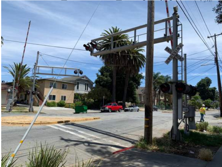
22_N 5 St Gate_facing W.jpg
