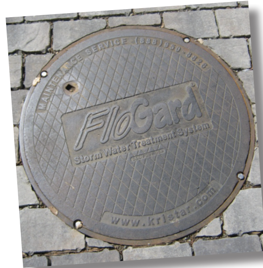
Arriba: Medida mecánica de tratamiento del agua de lluvia, tapa de boca de inspección
